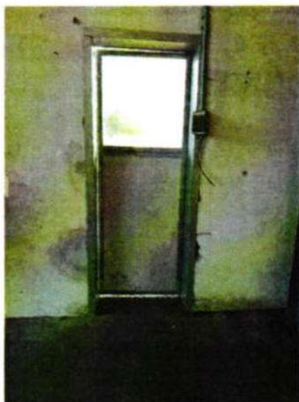
Foto 5 porta tra lattoneria e officina
