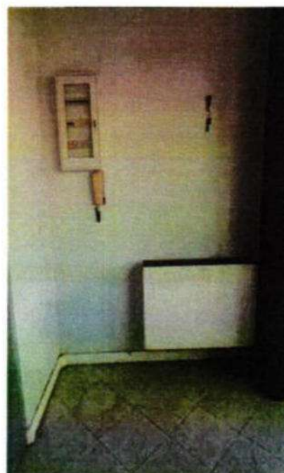
Foto 36 impianto citofonico e ventilconvettore
